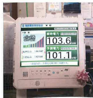
デマンド計測モニター
