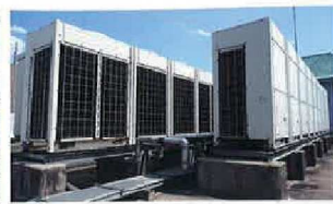
屋上の室外機
