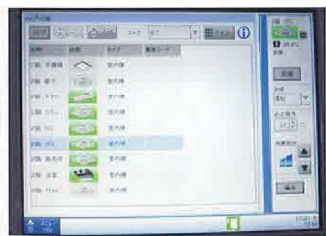
空調の運転状況
